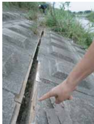
護岸ブロックにヒビ割れ (昨年9月)
